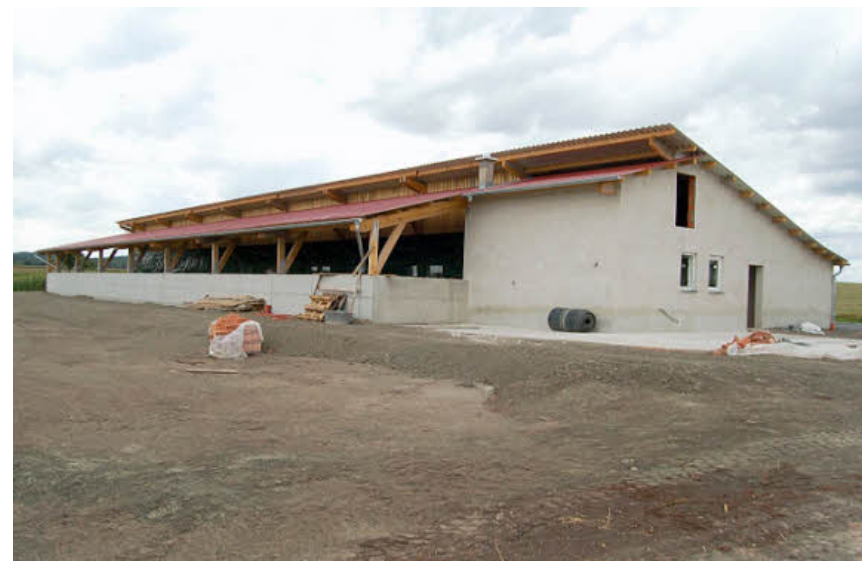
In „Pigports“ herrscht nie dicke Luft, sie sind energieeffizient und nicht so teuer wie andere Bautypen. Der Stall, der für Thomas Schreiner gebaut wird, hat noch ein paar Besonderheiten mehr.
